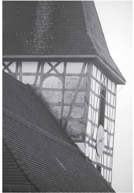
Deutlich sichtbare Schäden am Kirchturm.
